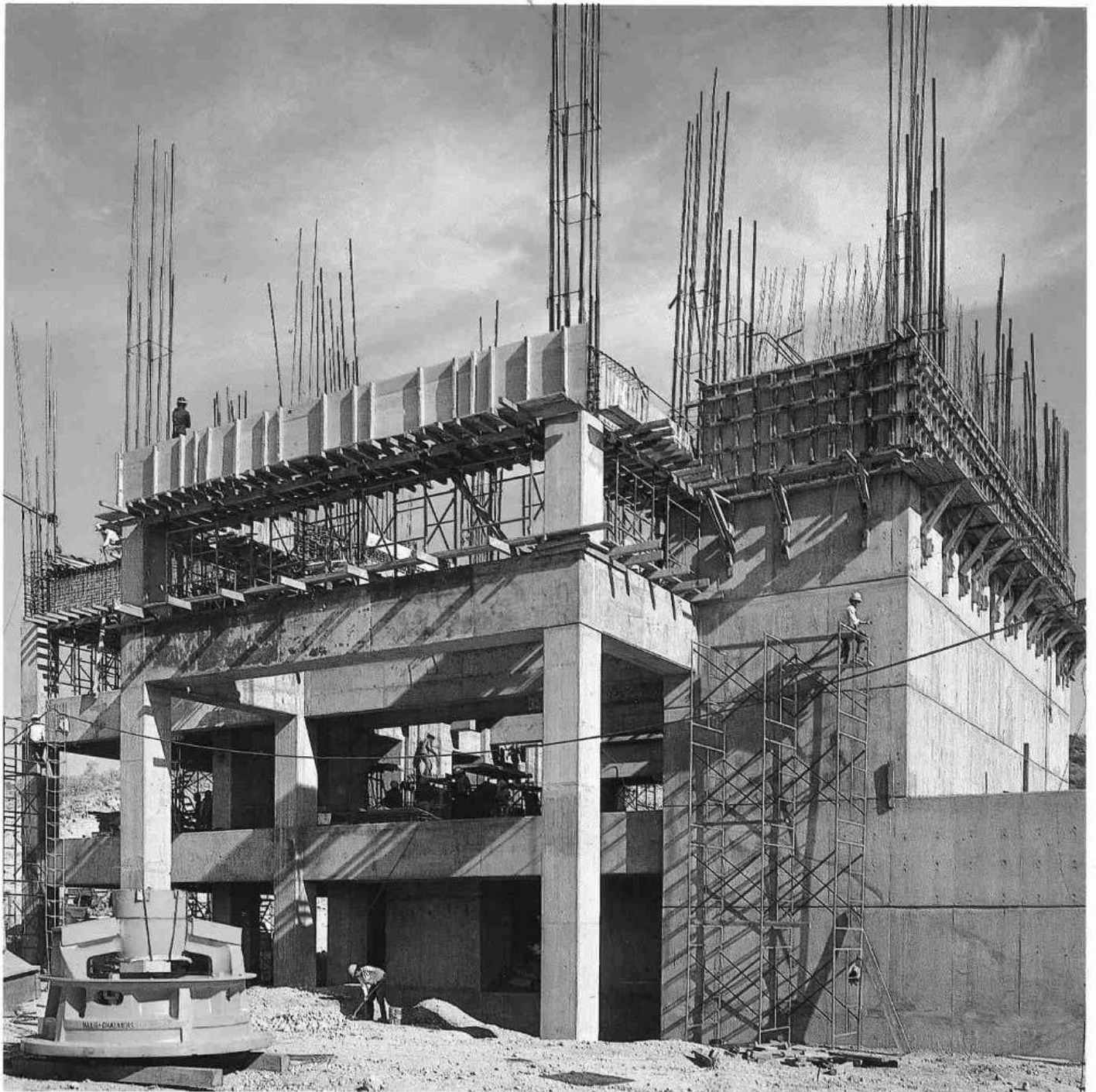
Edificio de trituración secundaria y terciaria en la Planta de Hermosillo.
